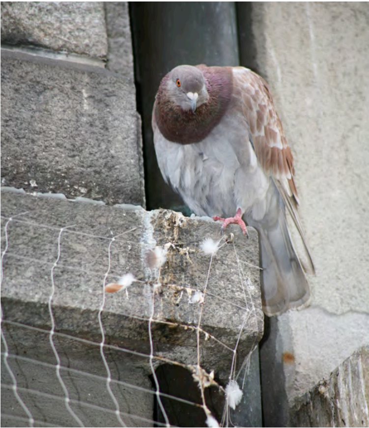
Abbildung 1: Bei korrekter Montage und regelmässiger Wartung gehören Netze zu den tierschutzkonformen Abwehrsystemen. Hier wurde das Netz jedoch nicht flächendeckend verankert. Zusätzlich bietet der ungeschützte Sims den Strassentauben eine gute Sitzmöglichkeit. Die Gebäudefassade wird somit nicht nur weiterhin verkotet, sondern das mangelhaft verankerte Netz kann für Tauben und andere Vogelarten auch zur Gefahr werden. Foto D. Haag Wackernagel
